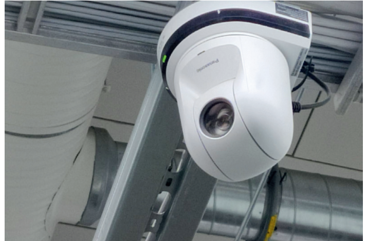
Lähikuva Pintakillan kattorakenteisiin kiinnitetystä kauko-ohjattavasta kamerasta.
