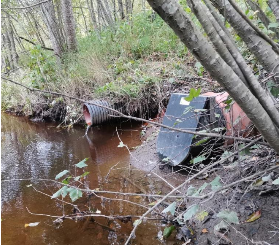
Ylivuotoputki 4 sijaitsee Myllyojan varrella ojan vesirajassa. Vieressä hulevesiputki (ei projektin kohdelistauksessa). Vedenpinnan nousu ojassa voi aiheuttaa veden pääsyä putkiin. Kuva: Matti Törmäkangas
